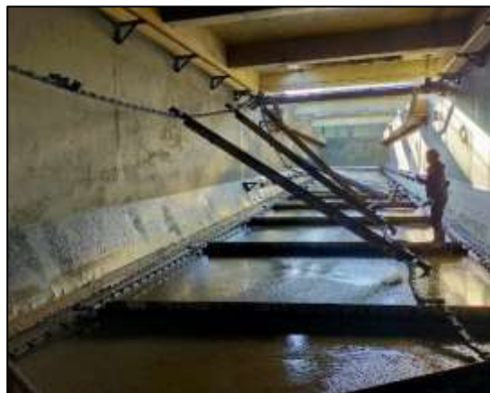
掻寄機のフライト板が脱落した状況 (下水道センター)
