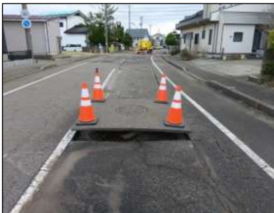
液状化により浮上したマンホールの状況 (五智 3 丁目地内)
