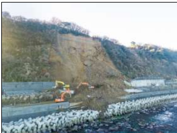
法面が崩落した国道8号（茶屋ヶ原地先）
