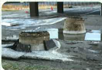
地中から突き出したマンホール
