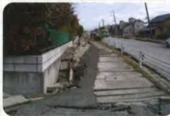
液状化で波打つ歩道
